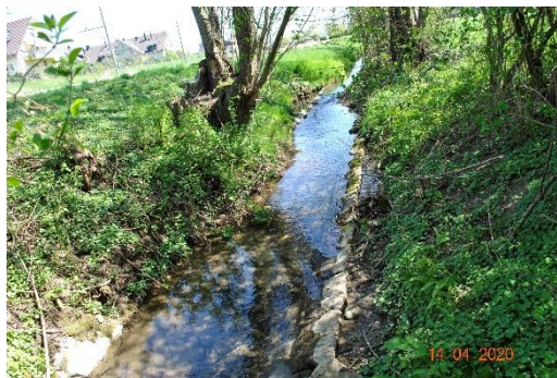
Foto 8: Bestehende Verbauung des Böschungsfusses mit deutlichen Erosionsschäden.
