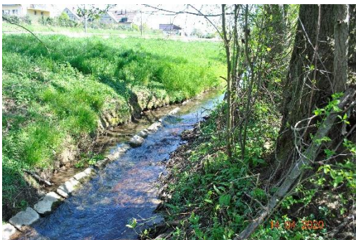
Foto 7: Bestehende Verbauung des Böschungsfusses mit deutlichen Erosionsschäden.
