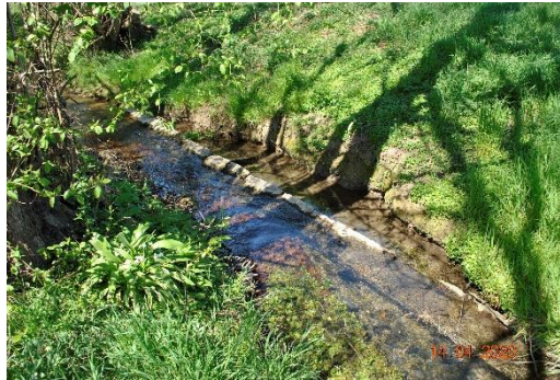
Foto 6: Bestehende Verbauung des Böschungsfusses mit deutlichen Erosionsschäden.
